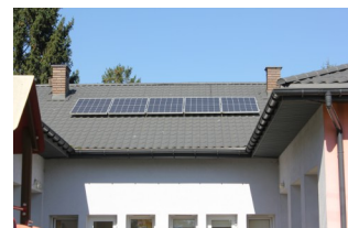
Instalacja fotowoltaiczna na Przedszkolu w Werbkowicach
